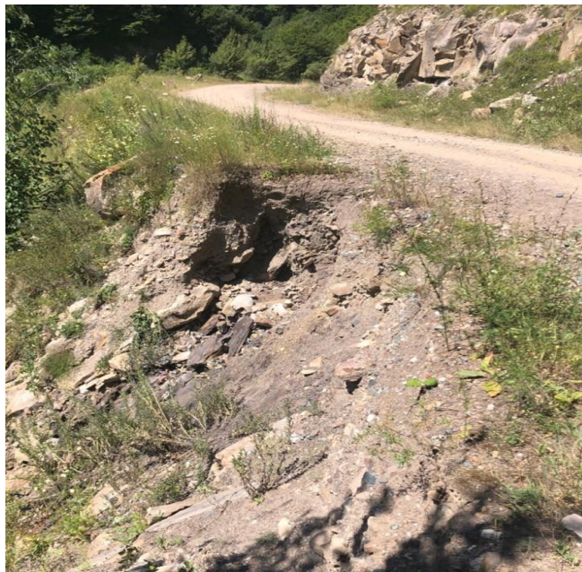
Рисунок 1 – Разрушение откоса водной эрозией
