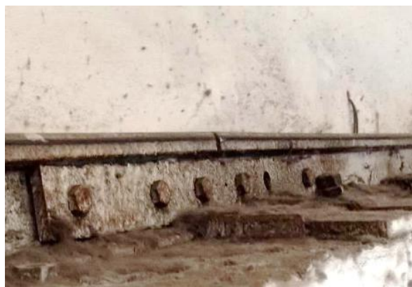
Рисунок 3 - Отсутствует болт соединения рельсов кранового пути
