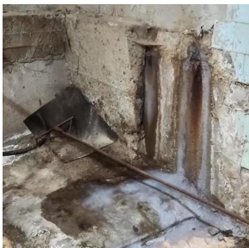
Рисунок 5 - Две точечные протечки грунтовых вод через стену
