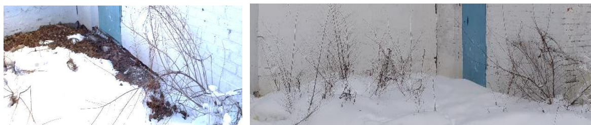
Рисунок 3 - Разрушение отмостки, поросли кустарника
