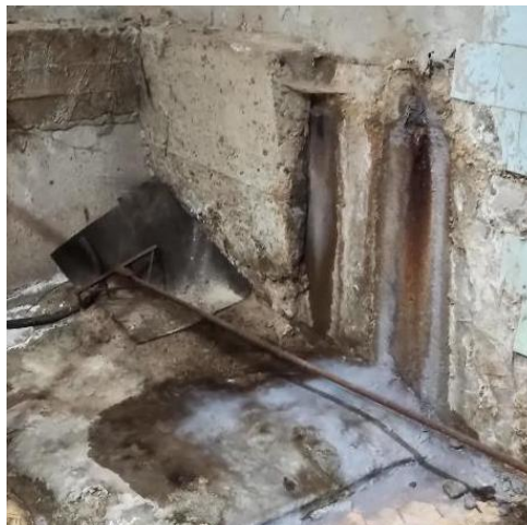
Рисунок 5 - Две точечные протечки грунтовых вод через стену
