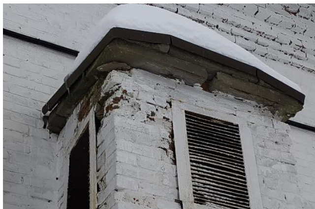
Рисунок 5 - Локальный участок разрушения кирпичной кладки в верхней части вентканала ( V \approx 0.003 \text{ м}^3 )
