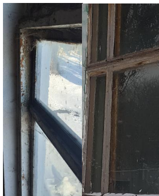
Рисунок 5 - Ветхое заполнение оконных проёмов с деревянными рамами и переплётами
