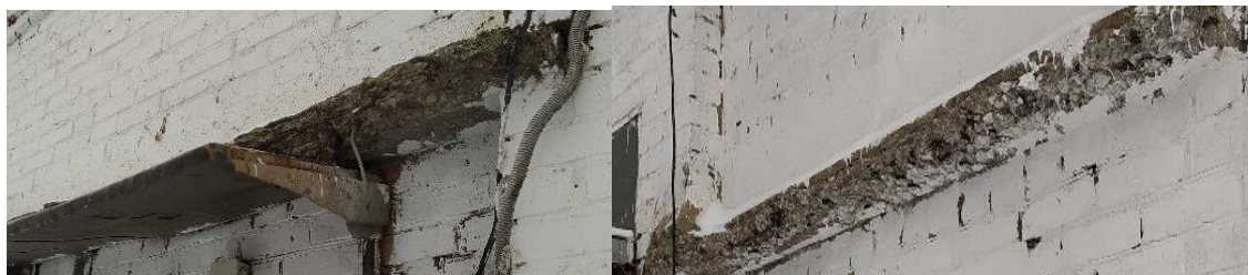
Рисунок 1 - Разрушение защитного слоя бетона, коррозия арматуры железобетонного козырька. В осях А-Б/7 коррозия металлического козырька
