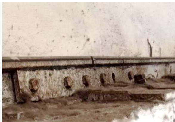
Рисунок 3 - Отсутствует болт соединения рельсов кранового пути
