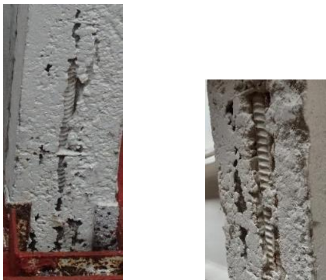
Рисунок 1 - Каверны по нижним поясам балок и обнажение рабочей арматуры
