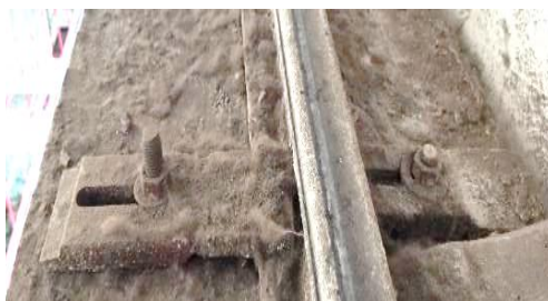
Рисунок 2 - Отсутствуют контргайки (или пружинные шайбы) крепления прижимных планок крепления кранового рельса к подкрановым балкам
