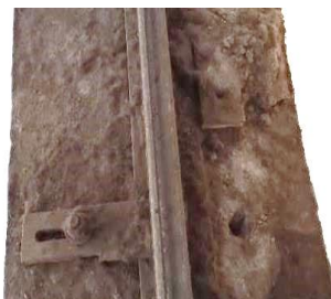
Рисунок 1 - Не закреплена (отсутствует) прижимная планка крепления кранового рельса к подкрановой балке в осях В/3-4
