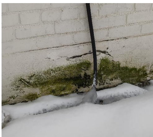
Рисунок 4 - Отслоение штукатурного покрытия ( S \approx 0.5 \text{ м}^2 )
