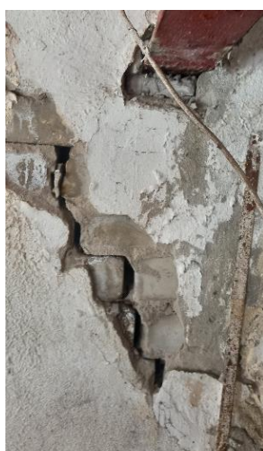
Рисунок 2 - Наклонная трещина в кладке стены шириной раскрытия до 5 мм
