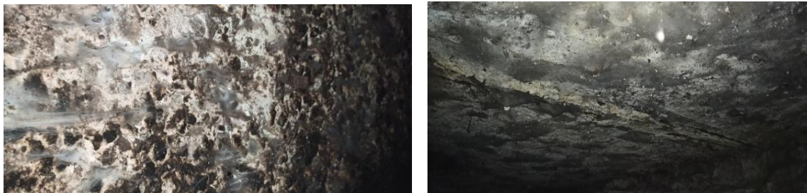
Рисунок 6 - Выщелачивание и шелушение поверхности бетона стен и перекрытия видимой части приёмного резервуара в осях А-Б/1-6
