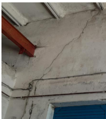
Рисунок 1 - Наклонная трещина в кладке стены шириной раскрытия до 3 мм
