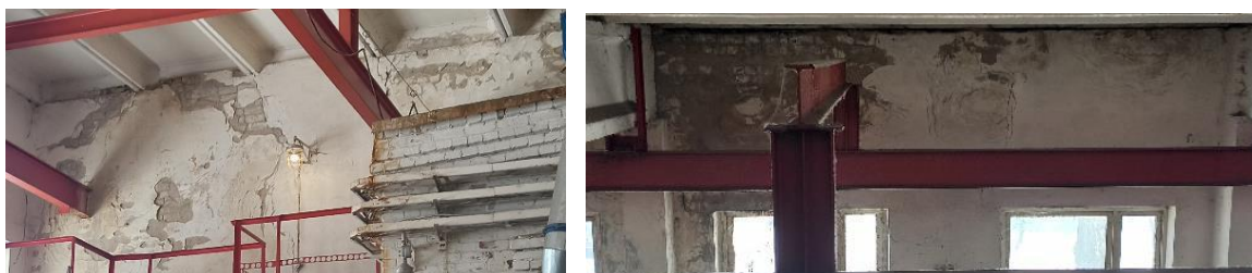
Рисунок 6 - Отслоение штукатурного покрытия наружных стен в помещении коллекторной
