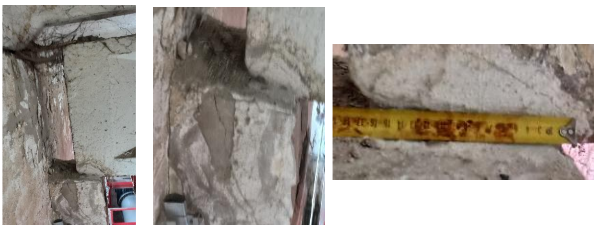
Рисунок 2 - Наклонная трещина в бетонной подушке пилыстры в месте опирания балки покрытия
