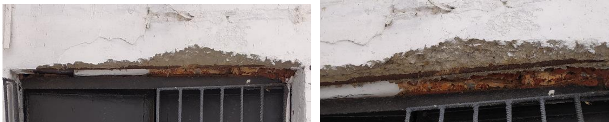
Рисунок 2 - Разрушение защитного слоя бетона, обнажение и поверхностная коррозия рабочей арматуры на участке l \approx 1,0 \text{ м}
