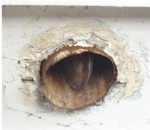
Рисунок 4 - Отслоение защитного слоя бетона, обнажение и коррозия арматуры полки плиты
