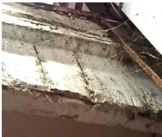
Рисунок 3 - Отслоение защитного слоя бетона, обнажение и коррозия арматуры
