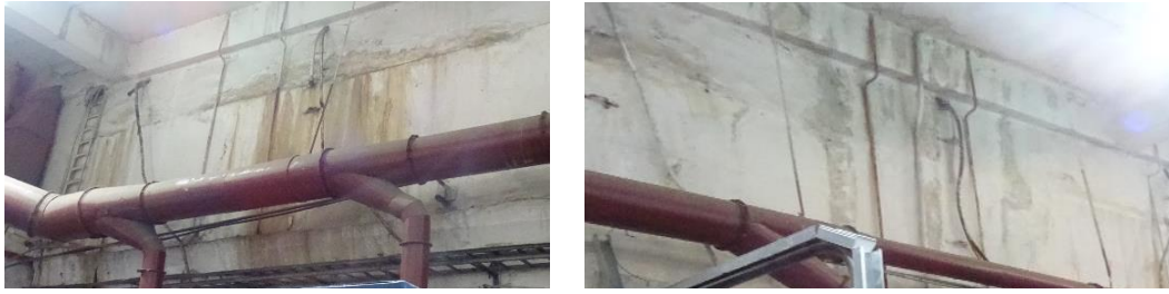
Рисунок 3 - Следы протечек грунтовых вод в урне отм. -1,50 стен нижнего строения
