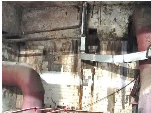
Рисунок 4 - Следы протечек грунтовых вод через стены нижнего строения
