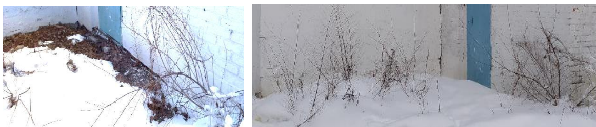
Рисунок 3 - Разрушение отмостки, поросли кустарника
